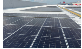
BP7-Jasper W1,W2 260kWp
