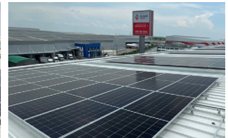
BP7-Jasper W3 240kWp
