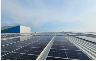
BP2-BTS W8 998kWp
